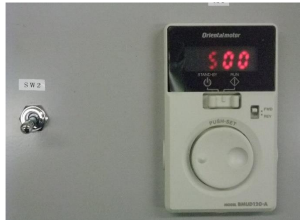
コントロール BOX
